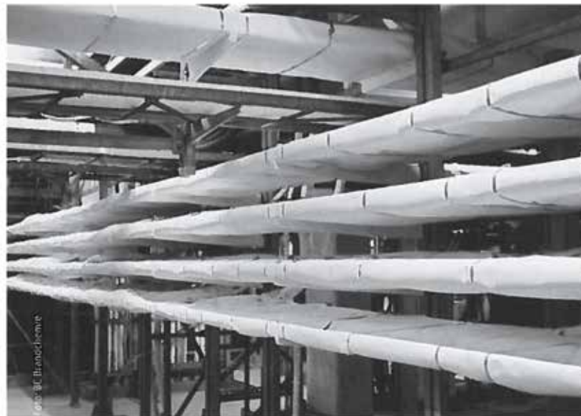
Abb. 1: Horizontale und vertikale Kabelanlagen mit bandagierten Kabelein- und -ausgängen in einem deutschen Großkraftwerk
