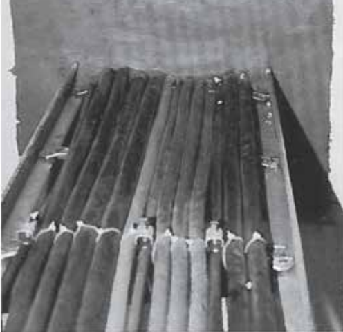
Abb. 2: Das Foto zeigt ein fertiges Mörtelschott. Es fehlen jedoch Maßnahmen, die eine problemlose Nachinstallation ermöglichen, z. B. Nachinstallationskelle.
