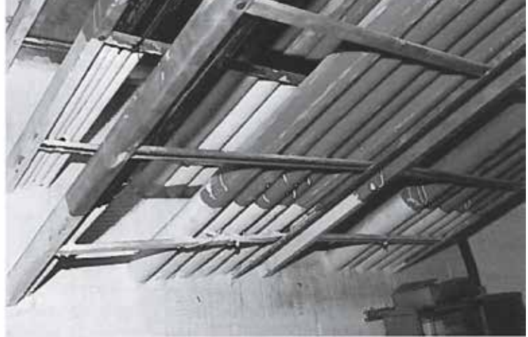
Abb. 3: Die Kabeldurchführung durch die Brandwand ist mit einem Mineralfaserschott gesichert. Durch ausreichende Arbeitsräume und saubere Kabelführung konnte dieses Schott sauber und fachgerecht eingebaut werden. Die erforderliche Kennzeichnung ist auf dem Bild nicht sichtbar.
